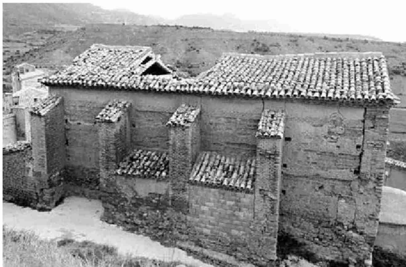
Imagen de la iglesia tras el derrumbe ocurrido en los últimos días. S.E.
