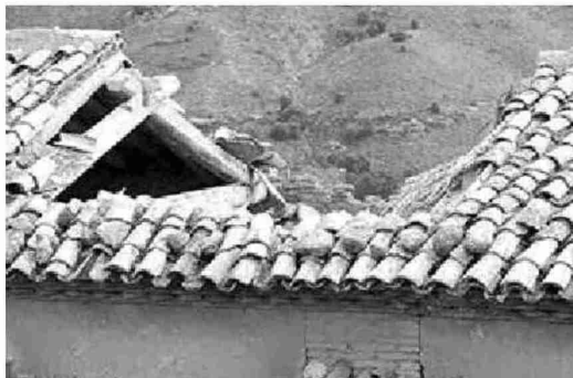
Detalle de la zona donde se ha producido el desplome. S.E.
